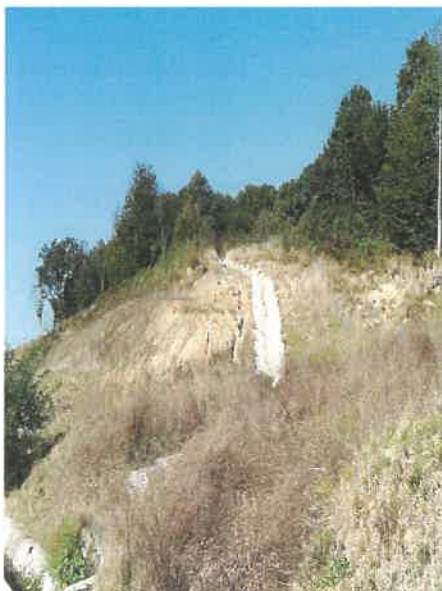
2.18. A 1 km 410+700 Calea 1 -alunecare taluz de debleu
