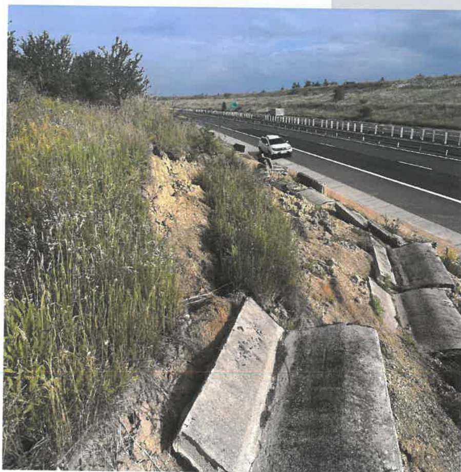
Foto aspecte zonă afectată
