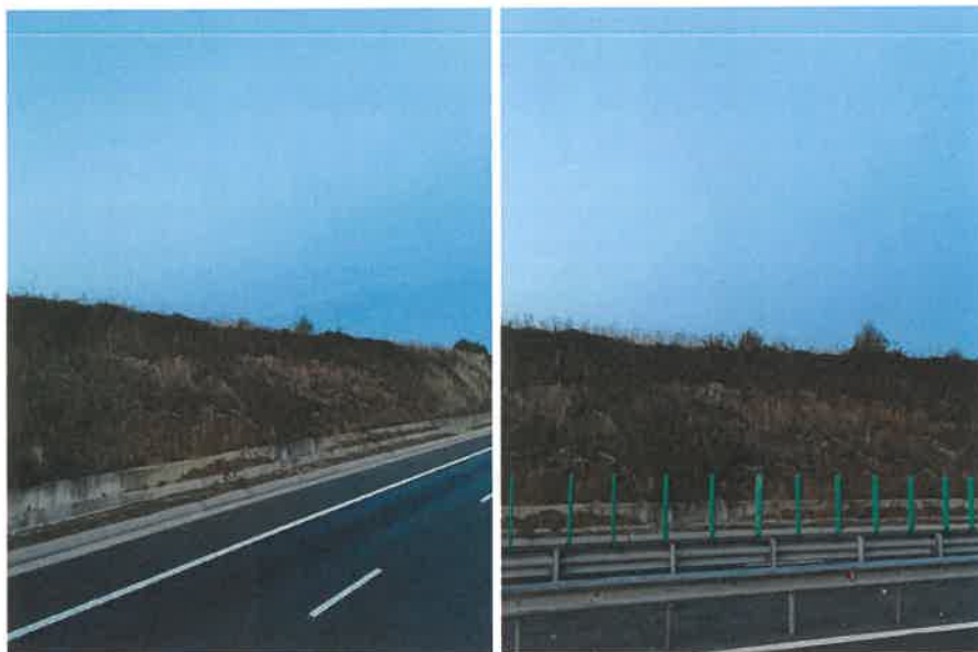
2.19. A1 km 442+080 Calea 2 -alunecare taluz de debleu
