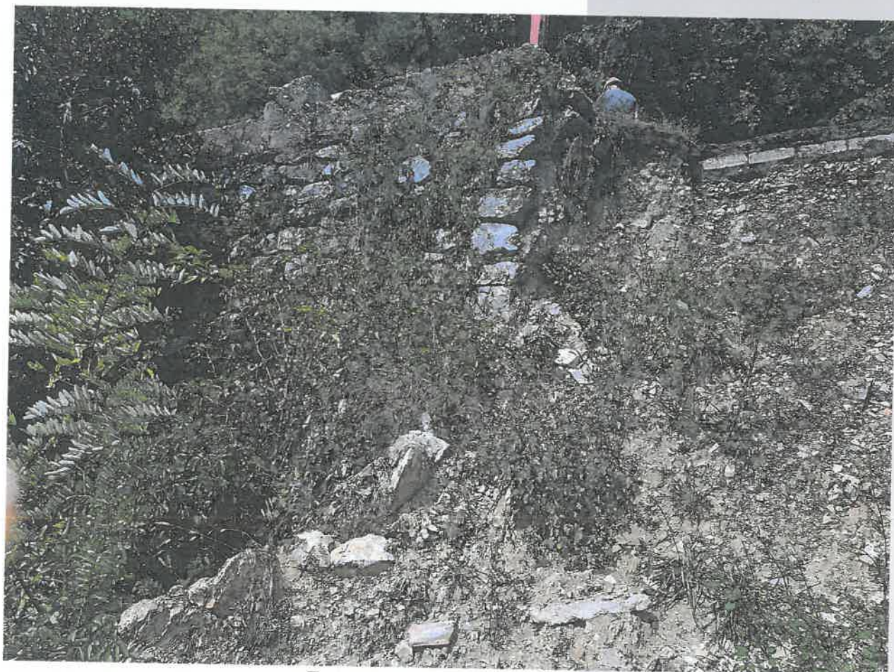
Foto aspecte zonă afectată
