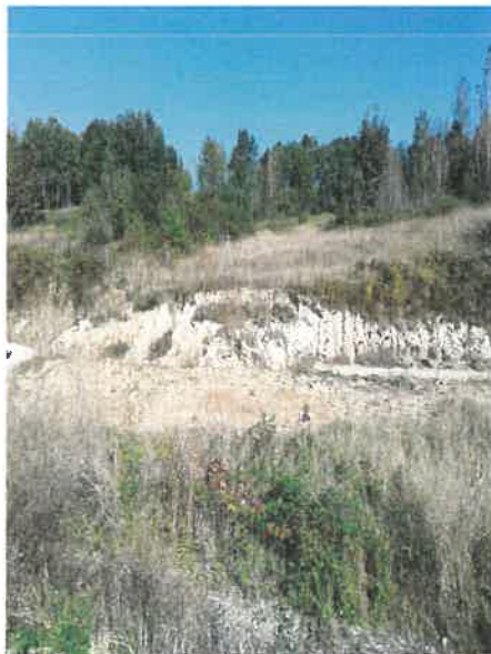
2.17. A1 km 409+600 Calea 1-alunecare taluz de debleu
