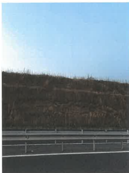
2.20. A1 km 442+670 Calea 2-alunecare taluz de debleu
