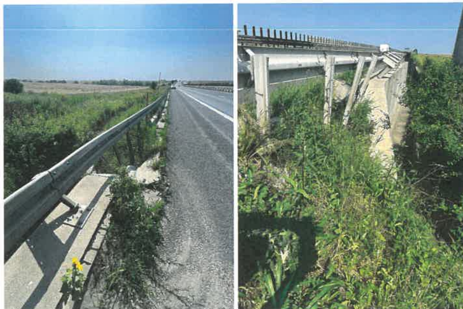
2.27. A1 km 502+700 Calea 1-alunecare taluz de rambleu
