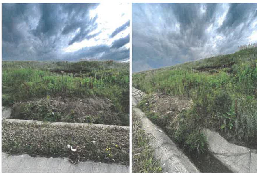
2.38. A6 km 4+040 Calea 2- alunecare taluz de debleu
