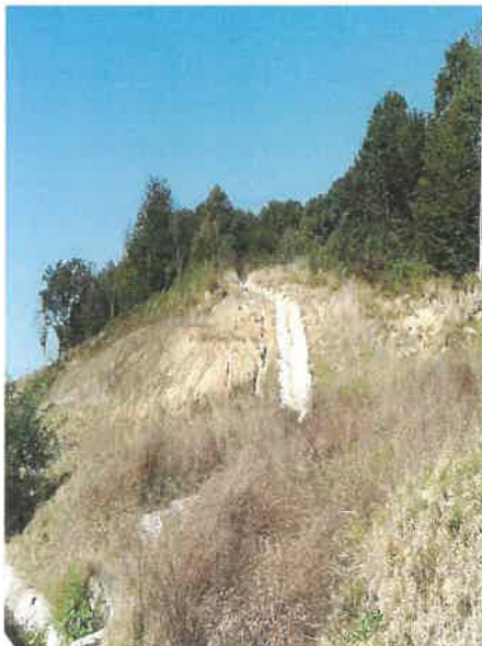
2.18. A 1 km 410+700 Calea 1 -alunecare taluz de debleu
