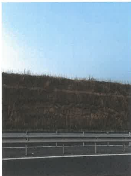
2.20. A1 km 442+670 Calea 2-alunecare taluz de debleu
