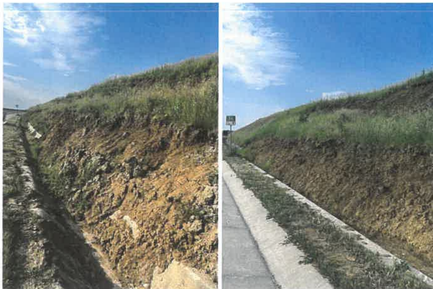
2.37. A6 km 3+935 Calea 1- alunecare taluz de debleu
