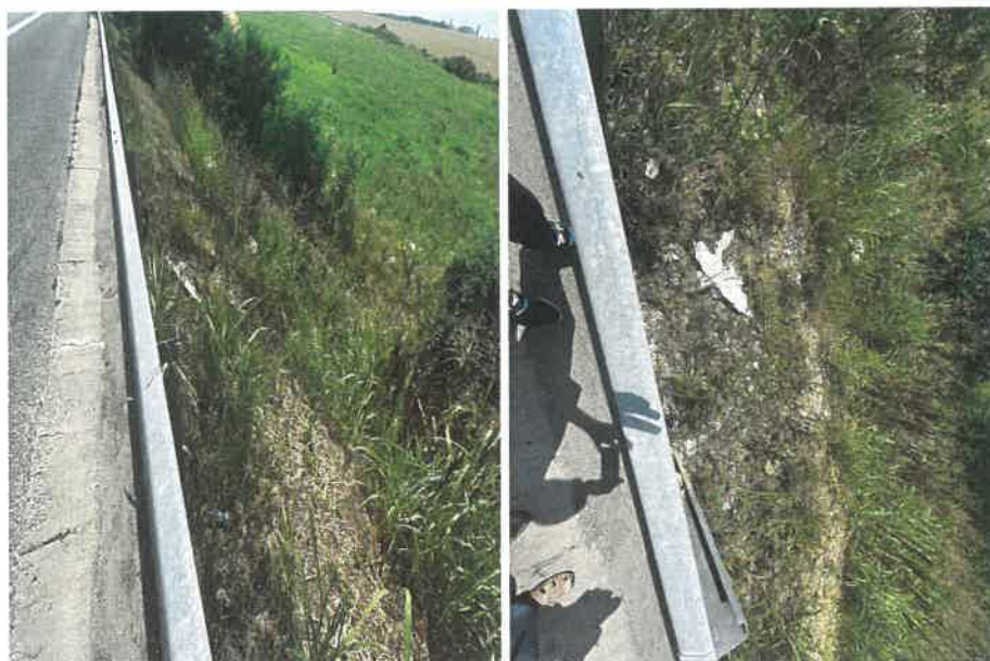
2.28. A1 km 505+000 Calea 2- alunecare taluz de rambleu
