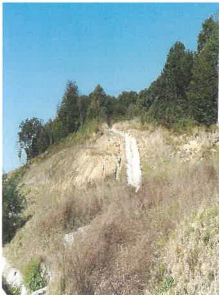
2.18. A 1 km 410+700 Calea 1 -alunecare taluz de debleu
